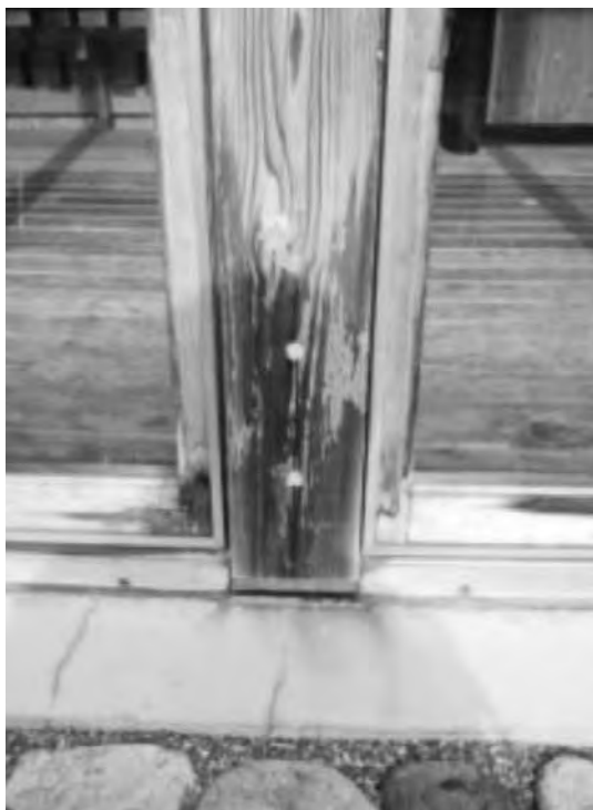
(写真 資料編から柱脚の腐朽の例)
