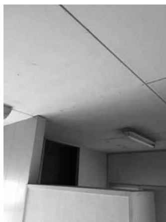
写真6 台所上部天井の状況
