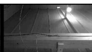
A室火源上部天井
