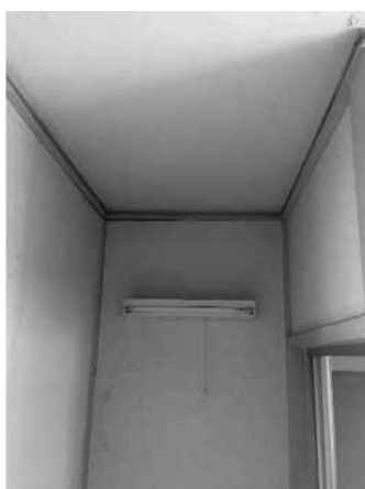
写真7 洗面所上部天井の状況
