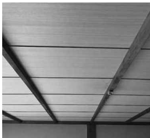
写真8 居室天井の状況
