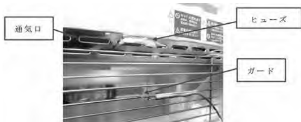
写真 5 通気口外側上部のヒューズ設置の状況
