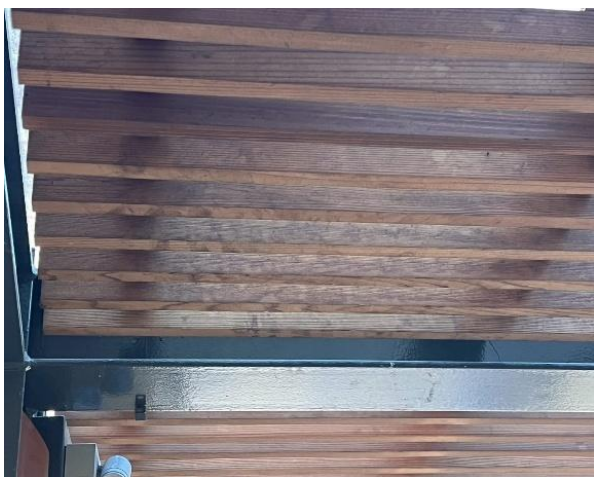
写真 3 ルーバー使用箇所の様子 1
