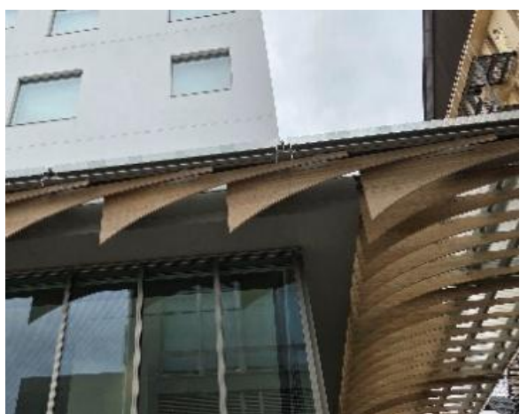
写真 28 軒天使用箇所 2
