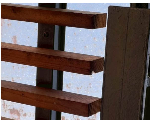
写真 4 ルーバー使用箇所の様子 2
